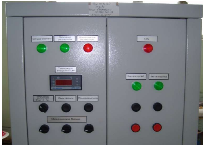
Рисунок 2.1 – Щит автоматики (двері)
